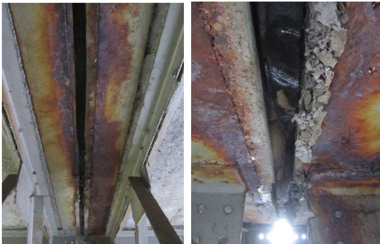
10 pav. Nesandarus deformacinis pjūvis, matyti dėl prabėgančio vandens korduojantis metaliniai elementai
