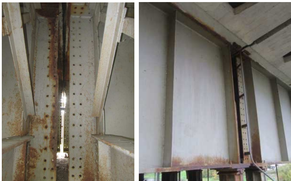
13 pav. Metalinių sijų korozija
