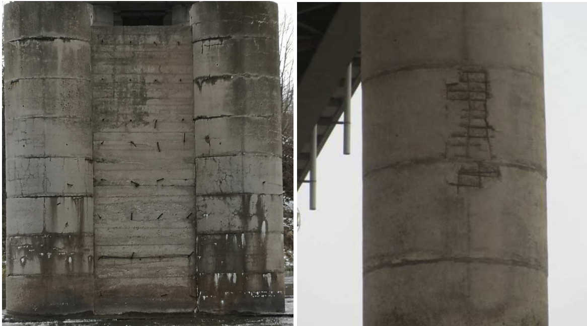
25 pav. Taurų žiedų konstrukcija suskilinėjusi, ištrupėjusios siūlės, matomi plaunami iš betono karbonatai. Atšokęs apsauginis betono sluoksnis, matoma koroduojanti armatūra
