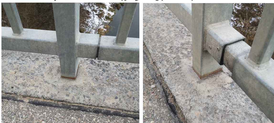
6 pav. Koroduoja turėklų statramsčių apatinė dalis jungtyje su betonu
