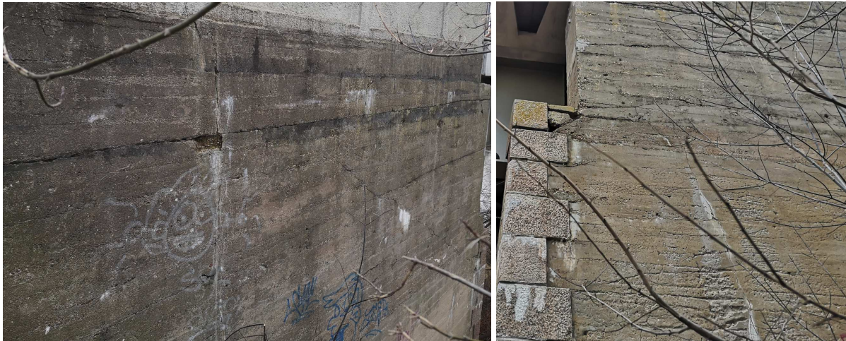
16 pav. Plyšiai ramtų sparnuose, matomos betonavimo ribos. Visas betono paviršius porėtas, daug ištrupėjusių vietų. Atskilęs betonas ties viršutiniu apmūrijimo akmeniu
