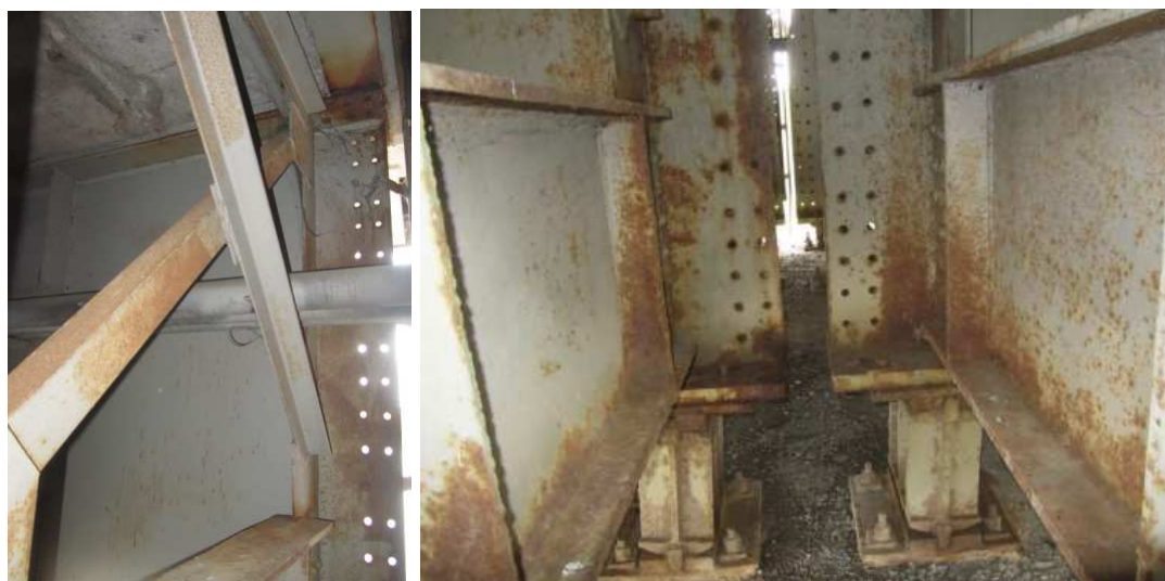
14 pav. Metalinių skersinių sijų korozija
