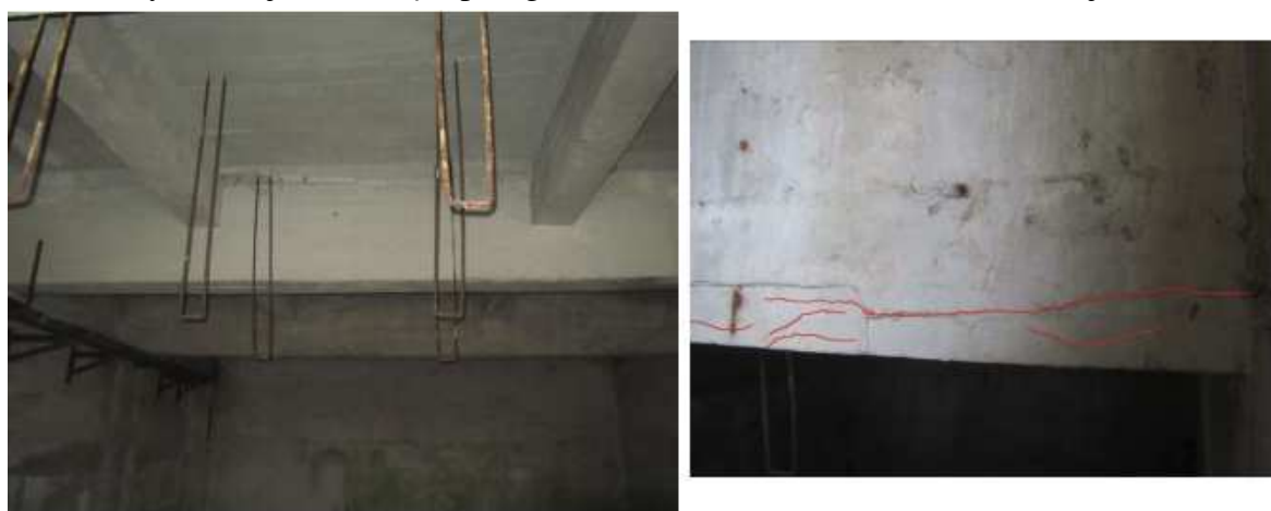
20 pav. Atramos Nr. 1 kameroje matomi sijose išilginiai plyšiai, tikėtina dėl prasidėjusios išilginės armatūros korozijos
