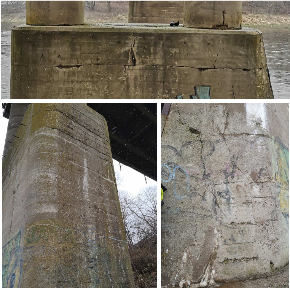
23 pav. Horizontalūs plyšiai ties 2 atrama, matomos betonavimo ribos. Visas betono paviršius porėtas, daug ištrupėjusių vietų. Ties lytlauža matyti atskilančio betono gabalai
