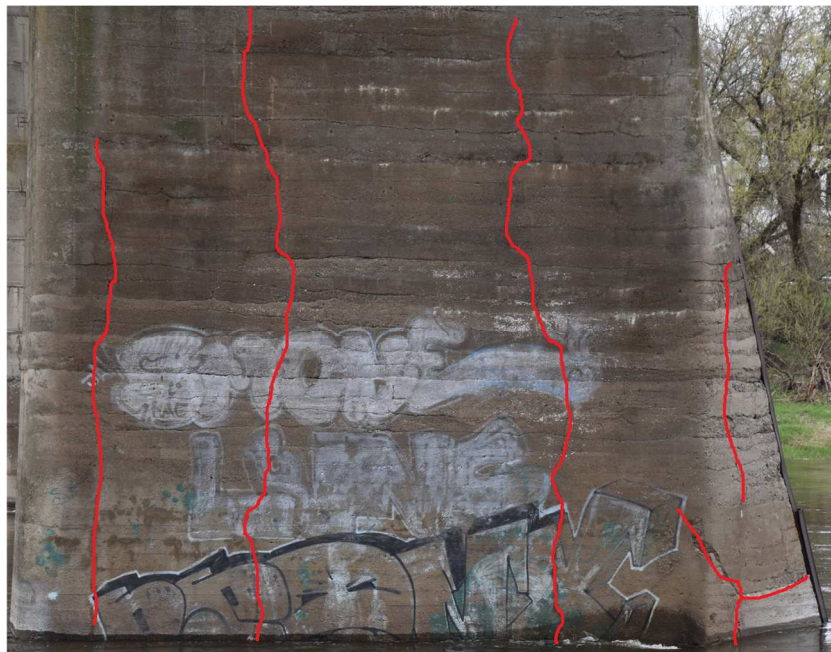
24 pav. Atramoje Nr. 3 betoninėje dalyje susiformavę vertikalūs plyšiai. Ties lytlauža matyti atskilančio betono gabalai
