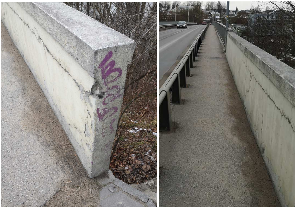
8 pav. Horizontalus įtrūkimas gelžbetoniniame turėkle virš ramtų
