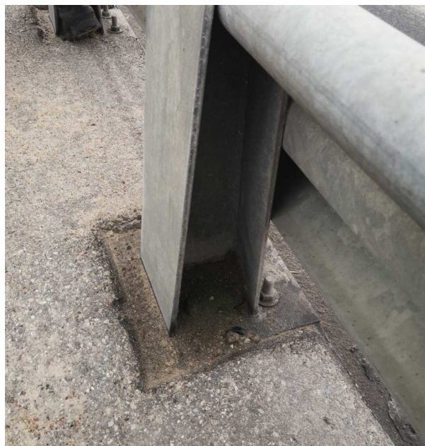
4 pav. Atitvarų atraminės plokštelės užneštos smėlio, purvu, galimos korozijos židiniai
