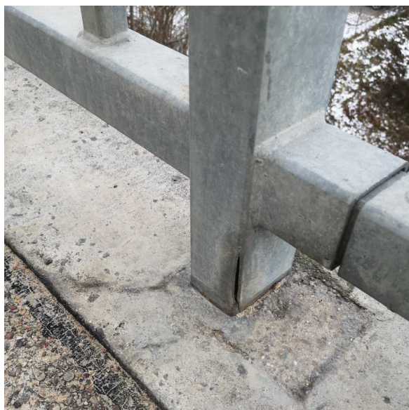
7 pav. Įtrūkęs turėklų statramsčio metalinis profilis
