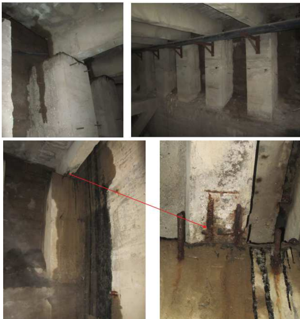
19 pav. Atramos Nr. 6 kameros nesandarus sujungimas su ramtų sienomis, matomos prasisunkiančio vandens žymės. Sijose atšokęs apsauginis betono sluoksnis, matoma koroduojanti armatūra
