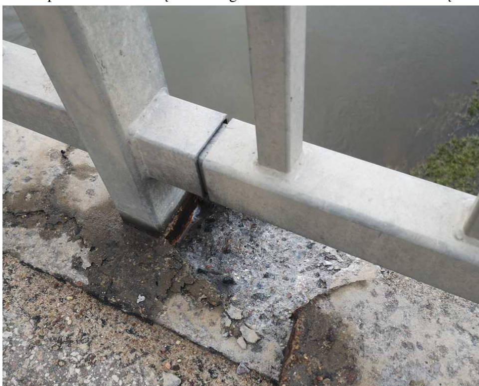
9 pav. Atšokęs betonas ant turėklinio borto ties turėklo statramsčiu
