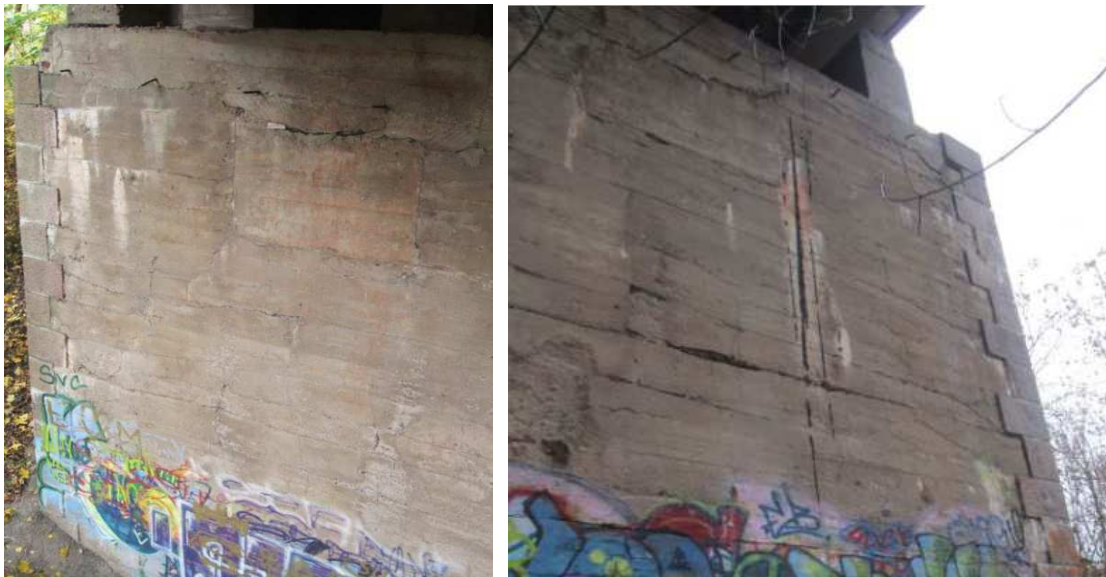
17 pav. Atraminė ramtų sienutė supleišėjusi, matomos betonavimo ribos
