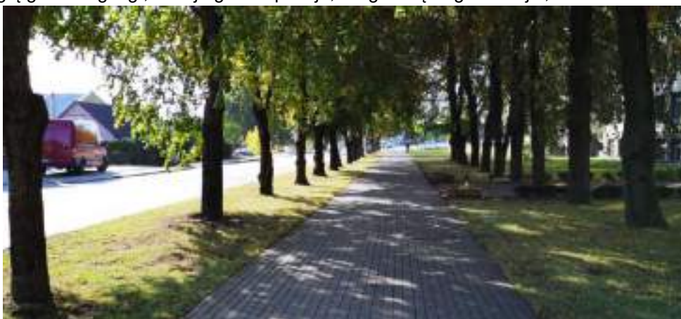
6. pav. Esama šaligatvio dangos būklė
