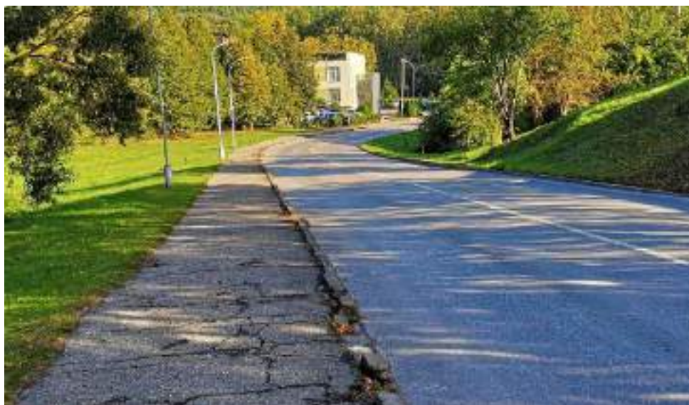
4,5. pav. Esama šaligatvio dangos būklė
